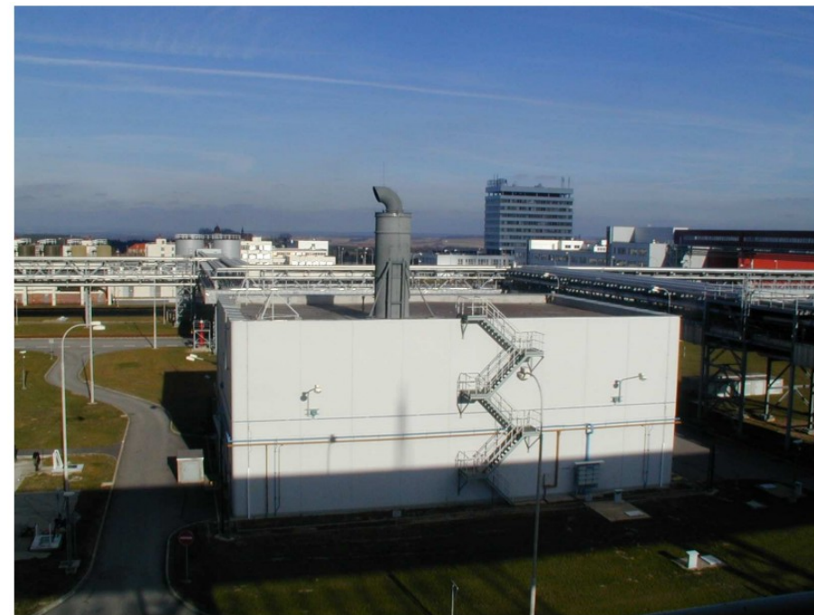
Systemová diesel generátorová stanice
