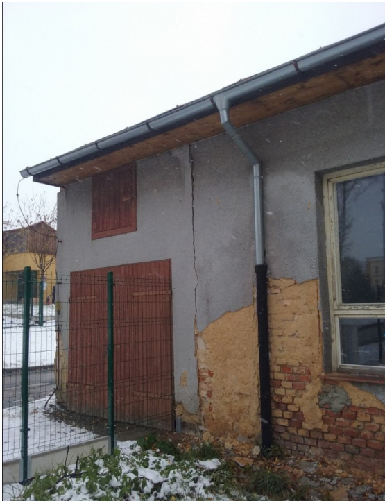
Obr. č. 8 vlhké zdivo exteriér Zdroj: vlastní fotodokumentace
