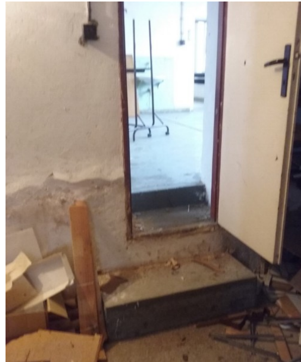
Obr. č. 9 vlhké zdivo interiér Zdroj: vlastní fotodokumentace
