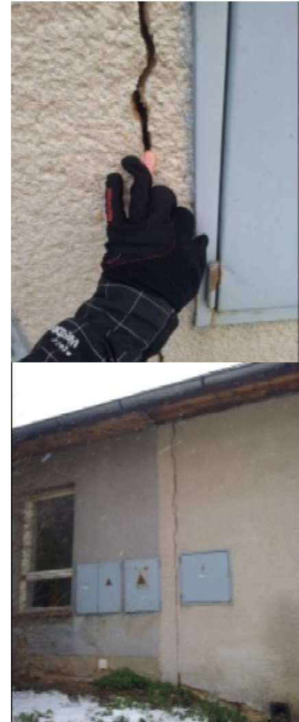
Obr. č. 8, 9 trhliny ve stěnách Zdroj: vlastní fotodokumentace
