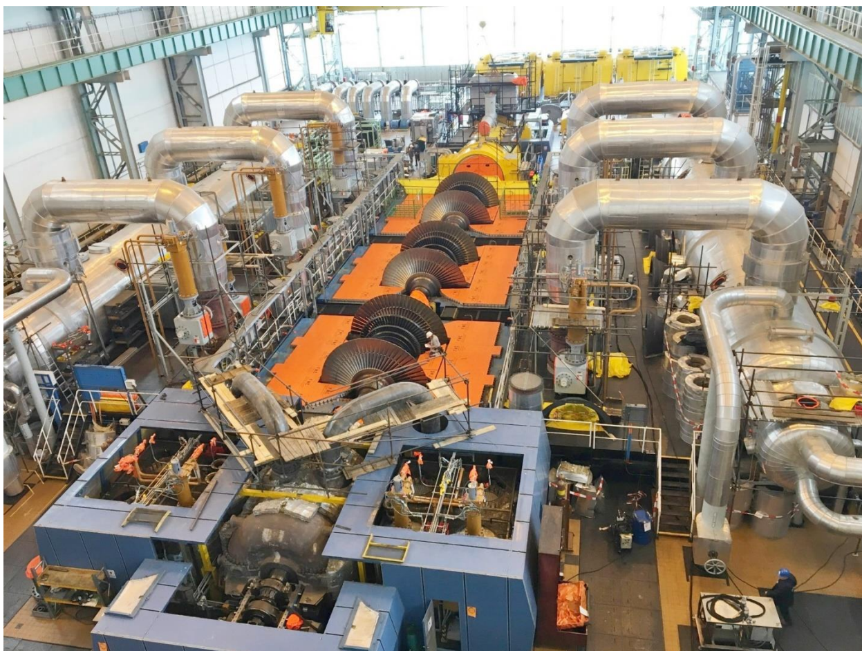
Obrázek 2: Pohled na turbínu v odstávce bloku z +31m.
