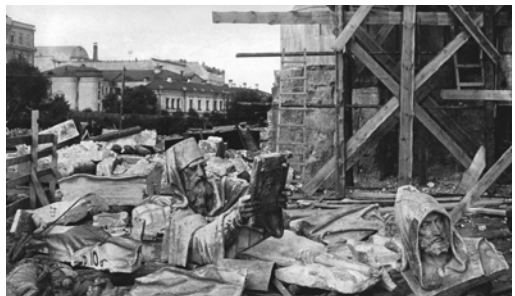
Obr. 13 Demolice chrámu Krista Spasitele v Moskvě. Staré symboly končí v propadlišti dějin, musí ustoupit novým. (Zdroj: http://www.tourofmoscow.com/cathedral-christ-saviour )
