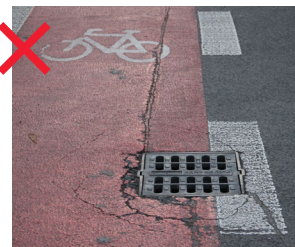
357 Nevhodné umístění vpusti dešťové kanalizace v rámci cyklopruhu; pro zvýšení bezpečnosti je alespoň dodatečně osazena mřížicí, do které kolo nezapadne [ Praha ]
