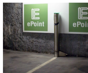
556 Dobíjecí terminály pro elektromobily by měly mít kultivovanou formu a měly by být umístovány v blízkosti parkovacích míst [ Praha ]
