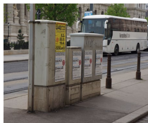
365 Skříň technické infrastruktury je vhodné umístit v ose sloupů, kde nepřekáží v prostoru, případně přecházení ulice [ Rakousko, Vídeň ]
