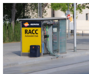
557 Drobná čerpací stanice s obsluhou vhodná do městského prostředí [ Španělsko, Barcelona ]
