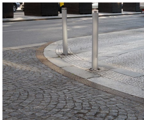
351 Odvodnění zvýšených křižovatek je vhodné provádět liniovými odvodňovacími mřížkami podél obrubníků [ Praha 6, Národní obrany ]
