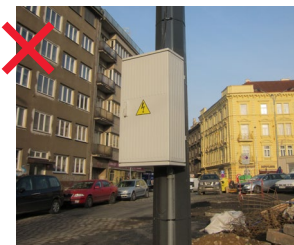
368 Umístění dodatečných mohutných prefabrikovaných skříní odlišné barevnosti na sloupech je nevhodné, zejména ve výšce, zasahující do průchozího profilu [ Praha 10, Moskevská ]
