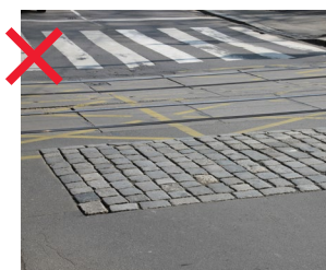
226 Záplata opatřená nevhodným materiálem nenavazujícím na okolní povrchy [ Praha 2, Karlovo náměstí ]
