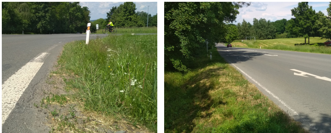
Obr. 14 Nánosy na krajnicích silnice č. II/105
