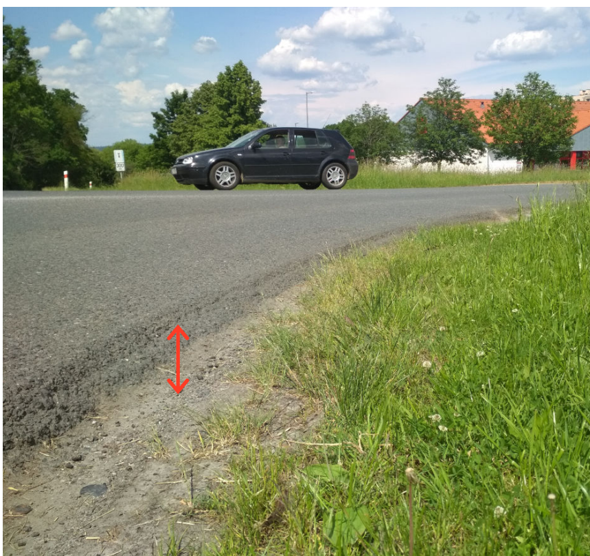
Obr. 15 Náhlý výškový rozdíl (cca 0,15 m) mezi vozovkou MK (ul. Blanická) a přilehlým terénem
