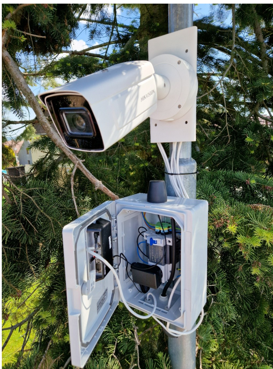
Obr. 3 | Ukázka instalace kamery včetně komunikačního rozhraní a el. vybavení
