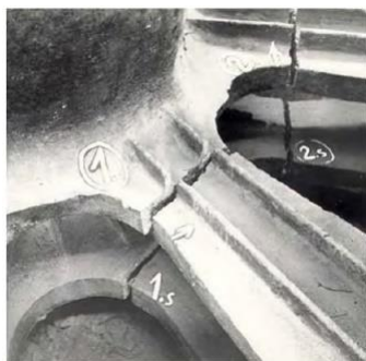
Obrázek – Trhlina za tepla
