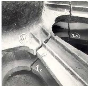
Obrázek – Trhlina za tepla
