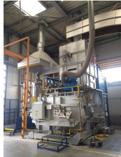
Obrázek – šachtová pec v provozu
