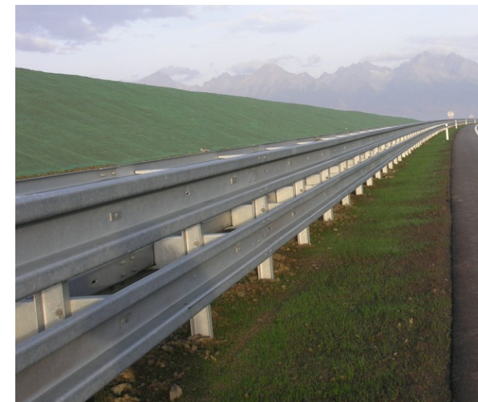
Svodidla – Liberty Ostrava
